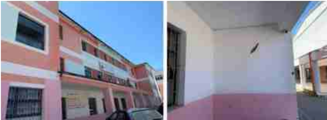
FIG 32- Shkolla Fillore në Lezhë (Muraturë e Papërforuar; Dëmtime Strukturore të Murit Mbjajtës (DS5)
