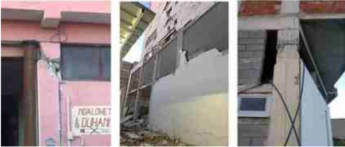
FIG 31- Dëmtimet në Ndërtesa prej Betoni të Armuar për Shkak të Tërmetit: Dëmtim i Kolonës; Dëmtim i Mureve Ndarës; Fenomeni i Kolonës së Shkurtër
