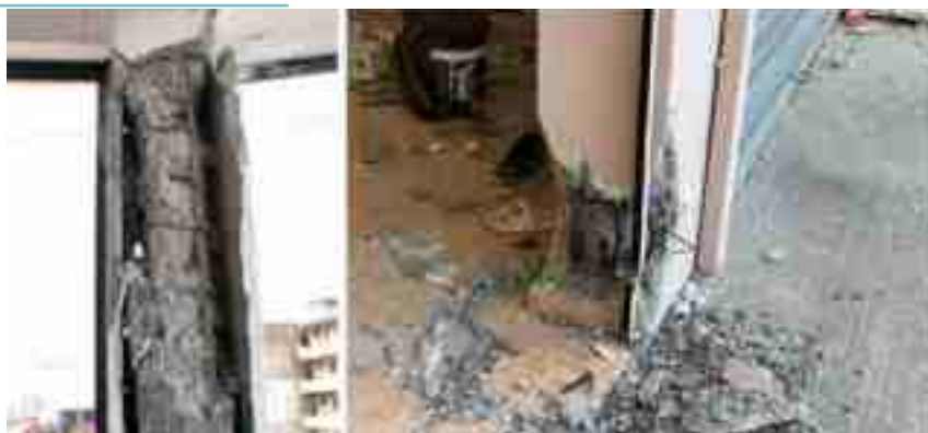
FIG 30- Shembuj Dëmtimi i Armaturës
